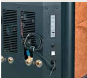
Consolle di emergenza Emergency console Consolle d'urgence Notbedienboard
